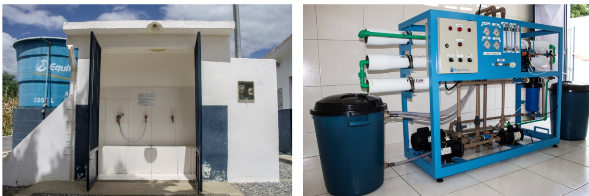
Figura 3.46 - Dessalinização de Água Subterrânea, Sítio Tabocas – Itatuba/PB.
