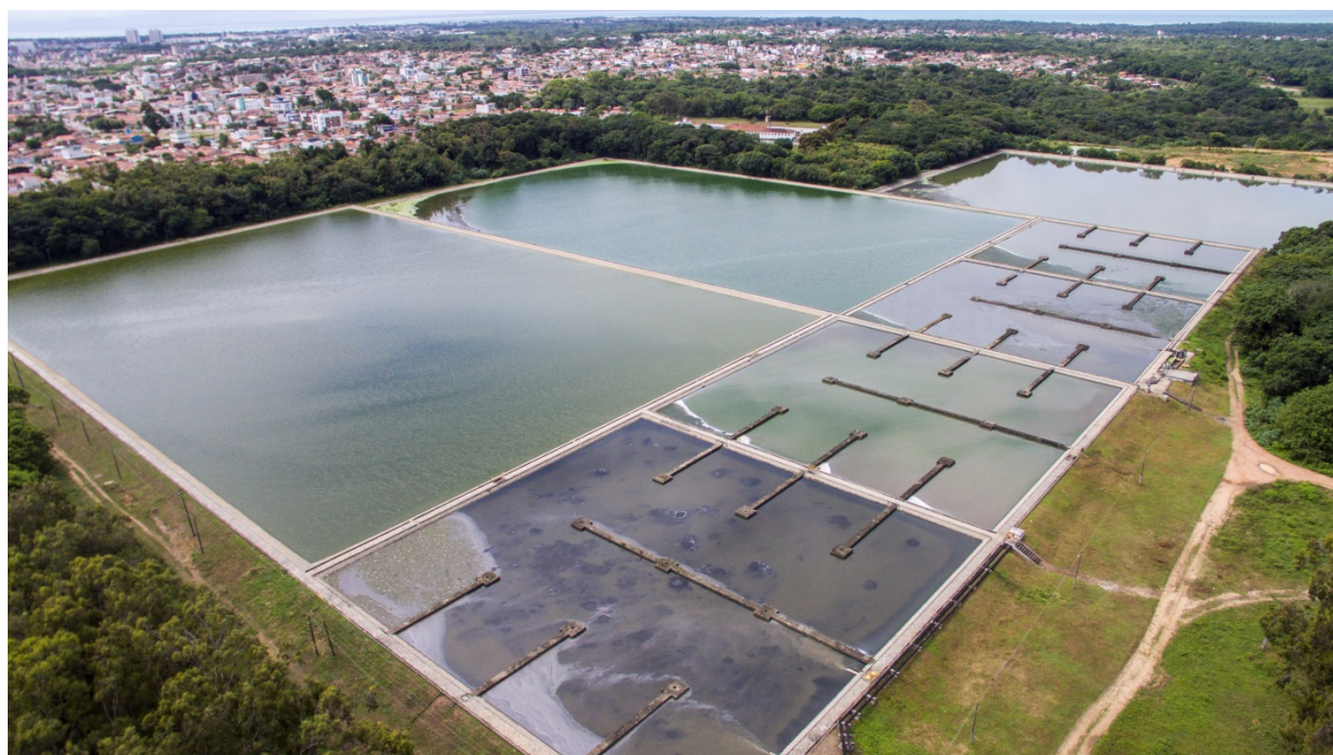
Figura 3.38 - Estação de Tratamento de Esgoto – ETE, João Pessoa
