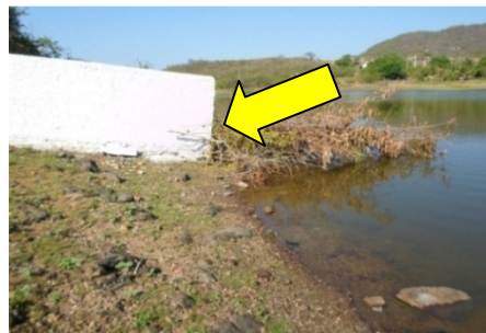
Muro construído em área de preservação permanente e adentrando no açude Cantinho.
