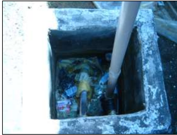
Foto 41 Lixo na área do sistema, sendo necessário um trabalho de conscientização do operador do sistema
